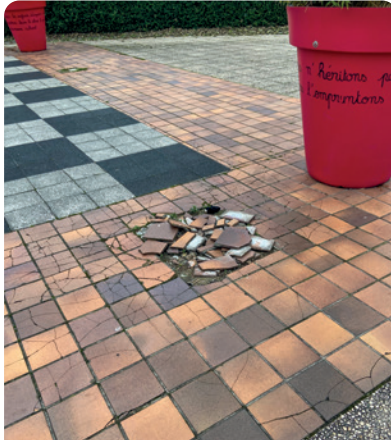
Le temps a fait son œuvre sur l'ancien dallage à proximité de l'Espace Salengro à Sainte Germaine. Il sera entièrement remplacé par la ville au mois de février.
